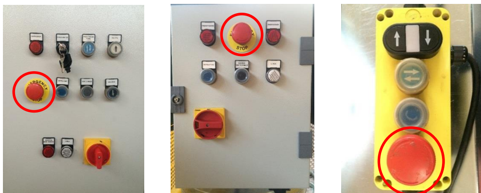
ГЛАВНЫЙ ЭЛЕКТРИЧЕСКИЙ ЩИТ УДАЛЕННЫЙ ЭЛЕКТРИЧЕСКИЙ ЩИТ КНОПЧНЫЙ
