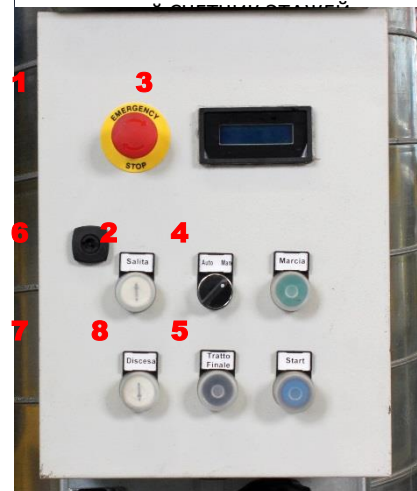
Рисунок 6 - Удаленный электрический щит системы управления с логической системой аварийной остановки
